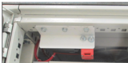
Figura 28 - Enclavamientos electrónicos de puerta
