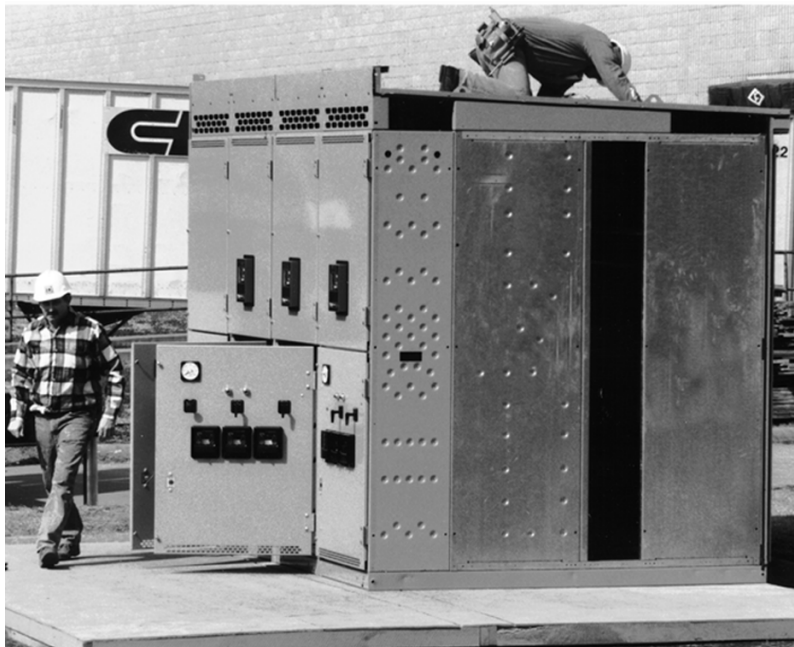
Figure 7 - Sécurisation des sections d'appareillage de commutation
