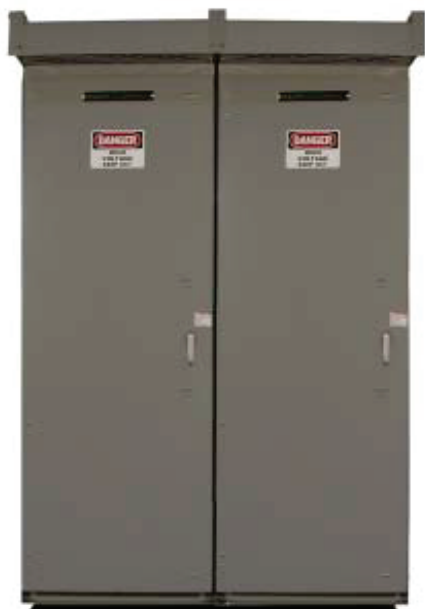
Figura 1 - Tablero de fuerza para exteriores sin pasillo de servicio
