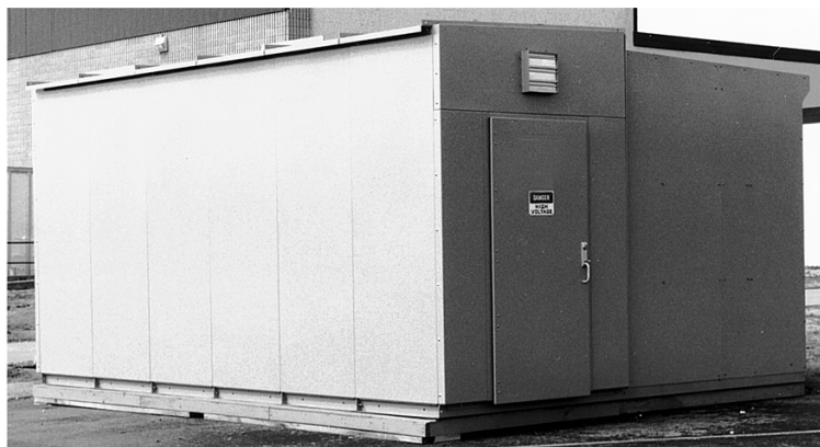
Figure 17 - Appareillage de commutation avec toutes les sections en place
