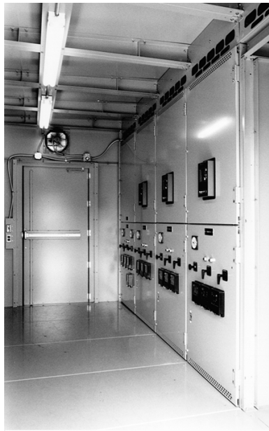
Figure 29 - Éclairage, prise et ventilateur
