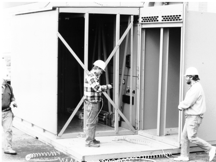
Figure 12 - Alignement de l'allée avec la section d'appareillage de commutation
