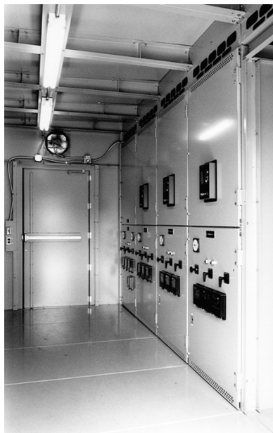
Figura 29 - Luces, receptáculo y ventilador
