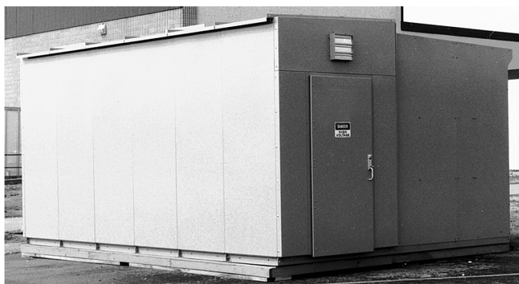
Figura 17 - Tablero de fuerza con todas las secciones en su lugar
