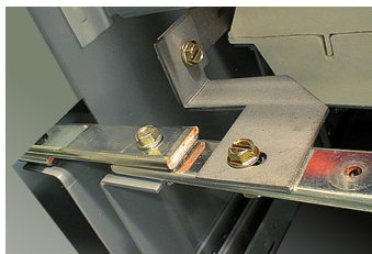
Figure 61 - Boulon de barre-bus de m.à.l.t. remis en place
