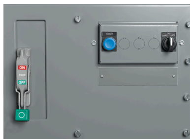
Figure 96 - Verrous de portes de CCM avec classification de confinement d'arc
