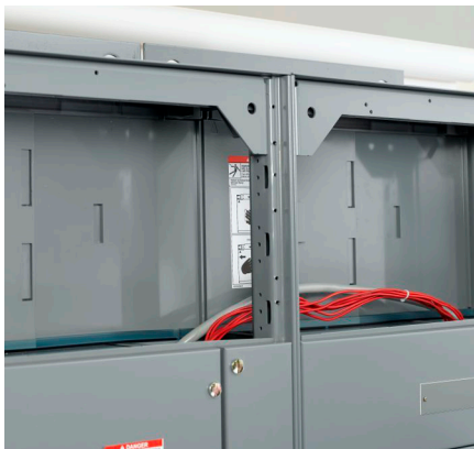
Figure 82 - Câblage dans la goulotte guide-fils horizontale supérieure
