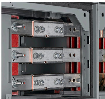
Figura 52 - Sin las cubiertas de los canales de cables y con las barreras de barras horizontales abiertas
