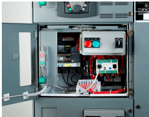
Figura 93 - Unidad de control
