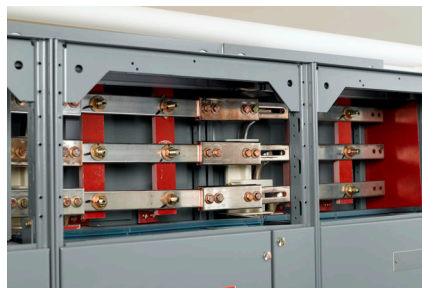
Figura 45 - Sin las cubiertas de los canales de cables y con las barreras de barras horizontales abiertas
