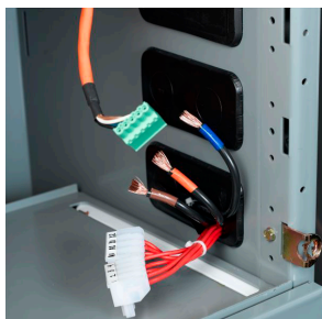
Figura 99 - Conductores de alimentación y parte superior de los bloques de terminales pasados por los agujeros para cables
