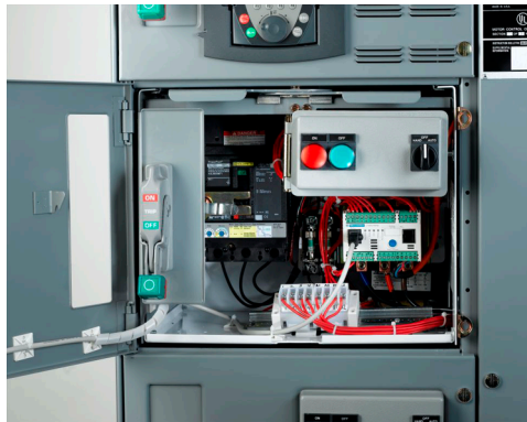
Figura 146 - Palancas a ras con el frente del CCM
